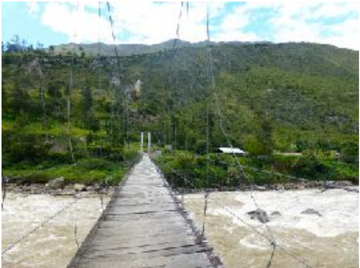
Die gefährliche Brücke, die über den reißenden Baliem Fluss führt
